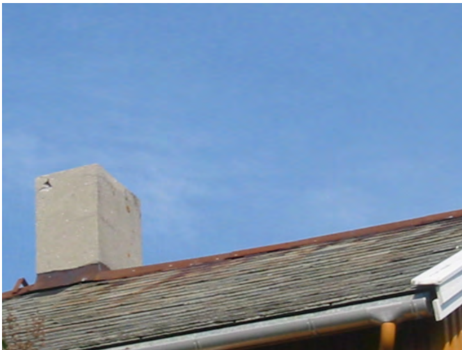
Original pipe og takfeste. Fra Torgny Segerstedsvei .
