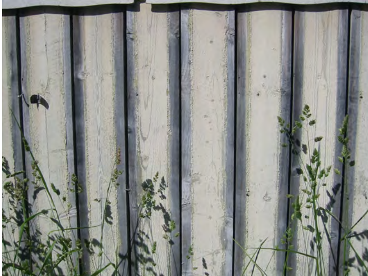
Rester etter originalt panel i Torgny Segersteds vei 2, nå skjult under eternitt.
