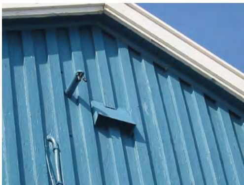
Original slutning mot taket, bordet under gavlrøsten er et typisk klassisistisk trekk. Fargen skal være original, det samme er panelet.
