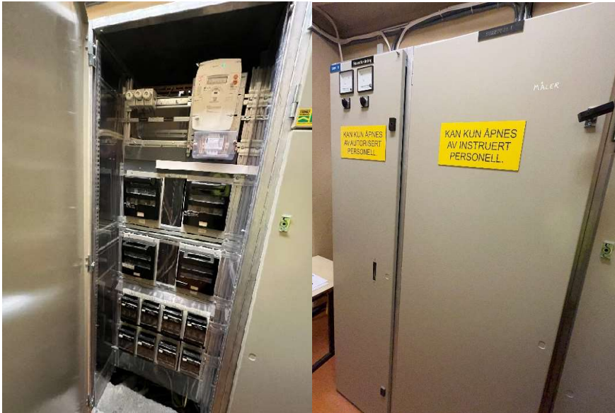
Hovedtavle fra byggeår.
