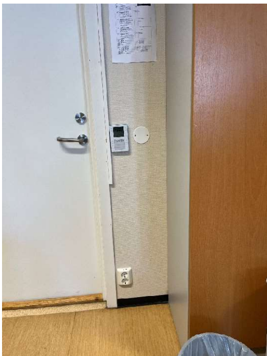
Representativt eksempel på byttet stikk, her med romkontroller for typisk klasserom/ arbeidsrom.
