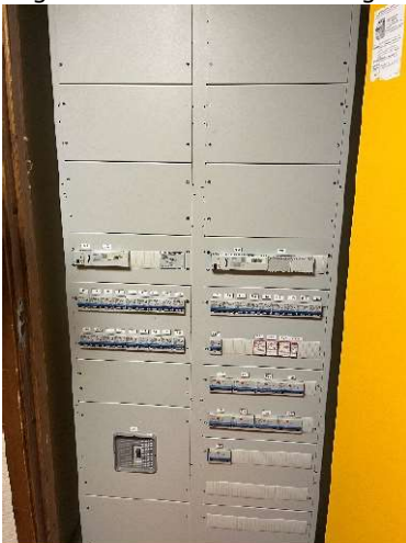
Typisk renoverert underfordeler i hovedbygget.
