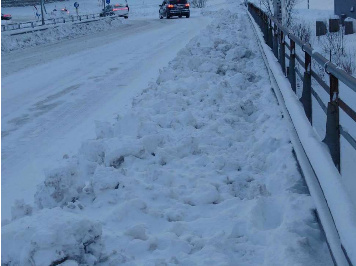
Bildet viser manglende brøyting av fortau på Hunstadbrua, ingen belysning og et klatrevennlig rekkverk.
