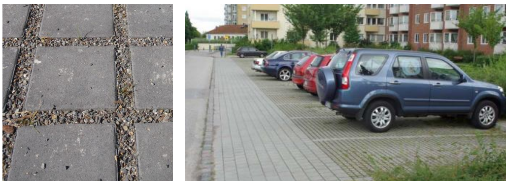
Figur 10. Eksempel på permeabelt dekke, foto WRS.
