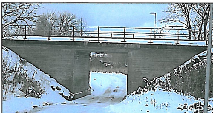
Fig.9. Eksisterende veikulvert under jernbanelinja er ikke dimensjonert for større kjøretøyer, f.eks brannutrykningsbiler.
