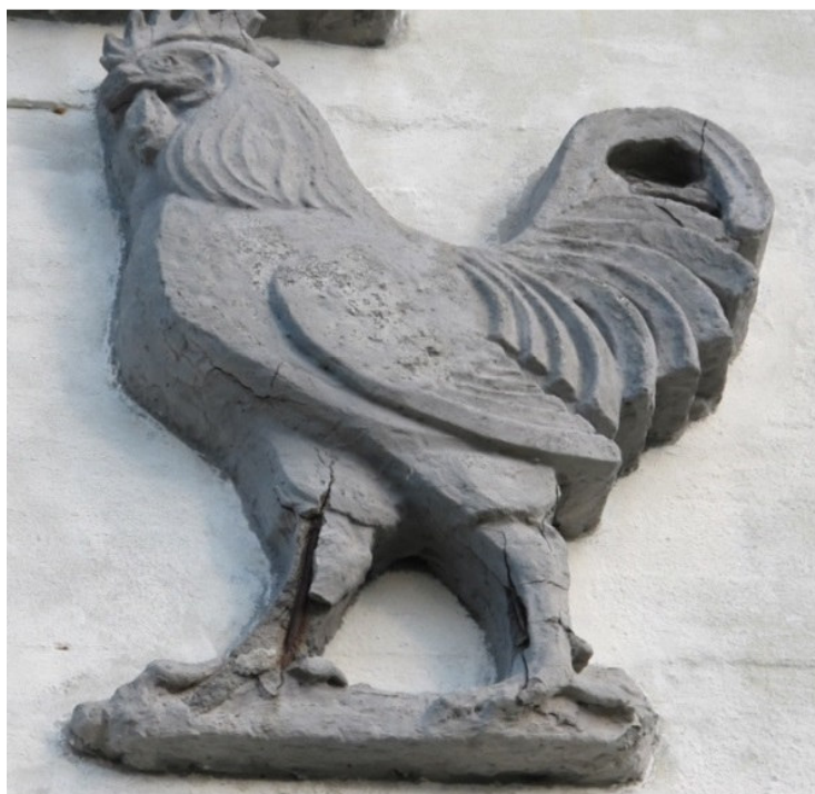
Figur 44. Ole Holand, relieff detalj. Skader på betongen. Foto Bjørg Heggstad Jakhelln 2017
