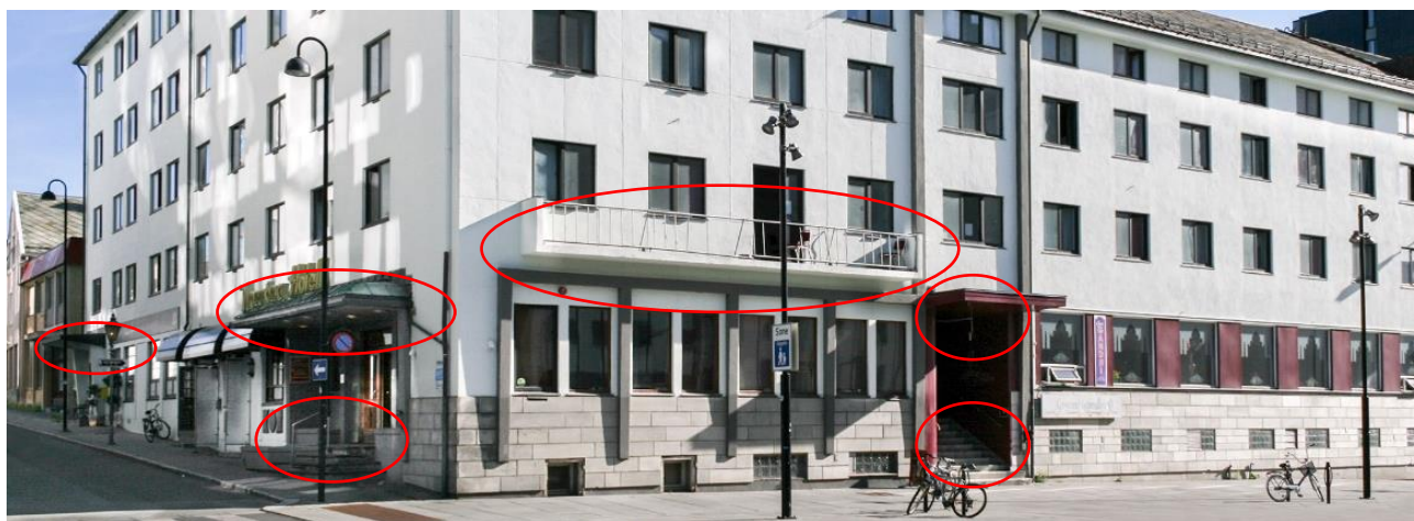
Figur 6 Eksempler på kuldebroer i fasaden. Foto; Norconsult AS
