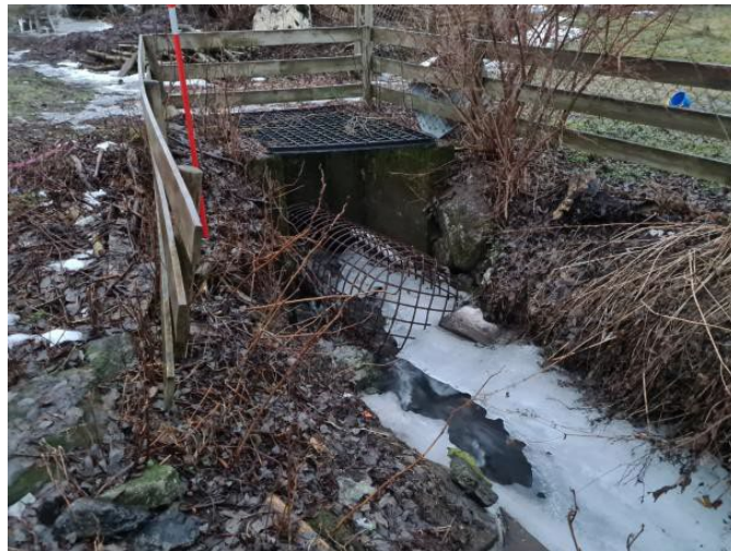
Figur 36: Bekkeinntak i Sørstrupen Foto: Norconsult
